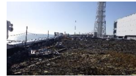
3号機 T/B 屋上部ガレキ (撤去前)
